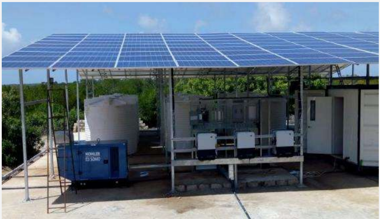
Kiunga, Lamu – 50 kWp Canopy Rooftop System
