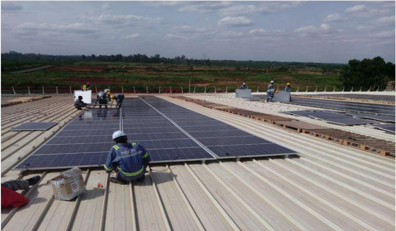
Ruiru, Kiambu – 303 kWp + 202 kWp Rooftop System
