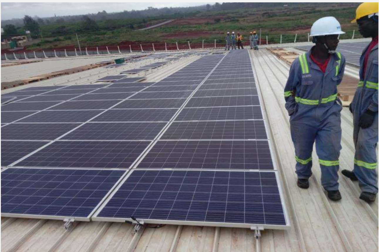
Ruiru, Kiambu – 303 kWp + 202 kWp Rooftop System
